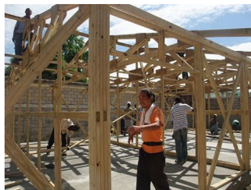
建設中の仮校舎の施工状況を確認する日本人建築専門家
